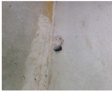
② 거더 파손 - 진전 여부확인
